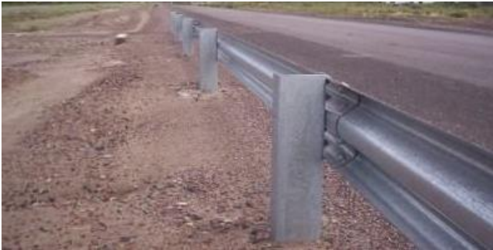
Ilustración 24: Defensas tipo Flex Beam
