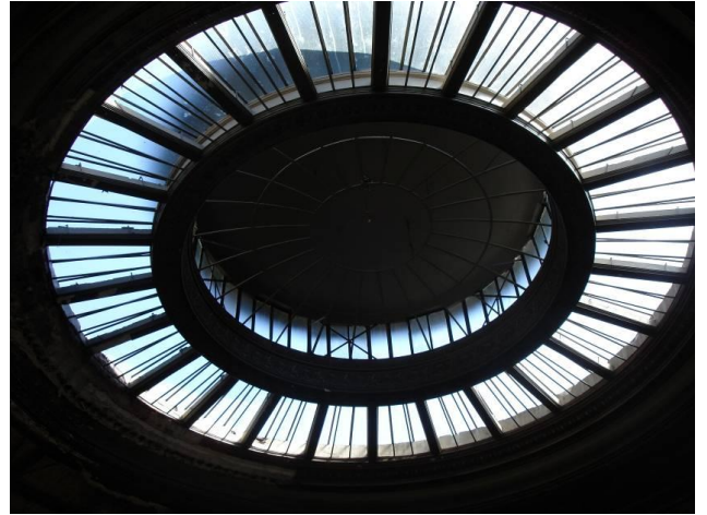
Foto n° 20: Detalle linterna después
