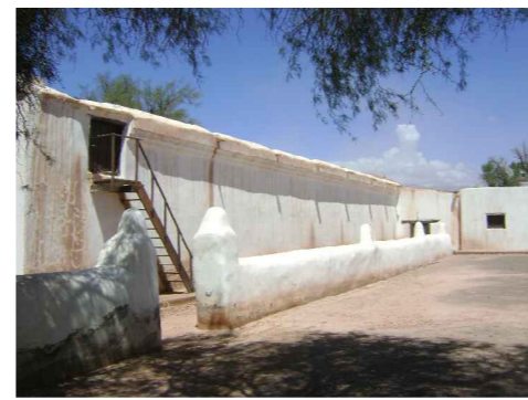
Deterioro de revoques y pinturas interior / exterior
