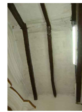
Consolidación de estructuras de madera y ajustes de cañizo. Reconstrucción de cielorraso, previo tratamiento de cubierta existente
