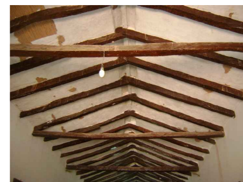
Baja iluminación interior
