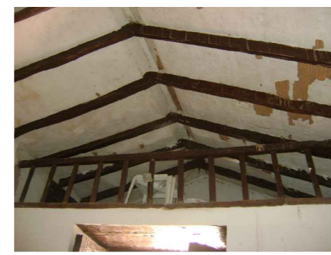
Inestabilidad de entrepiso coro y baranda.
