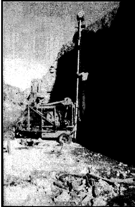
PERFORACIÓN DE ALUVIÓN “EL INFIERNILLO” – LA RIOJA
