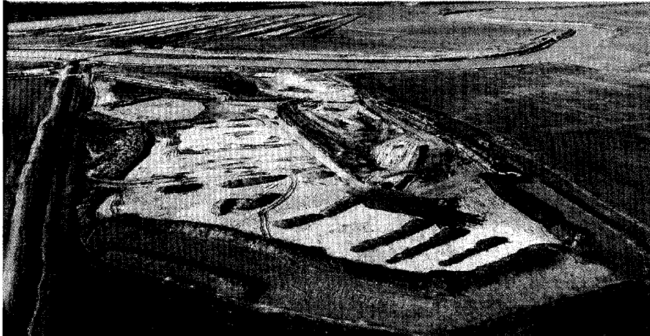
Recintos preparados para refulado y para suelo transportado en camiones – Rio Salado – Tramo III – Sector 1
